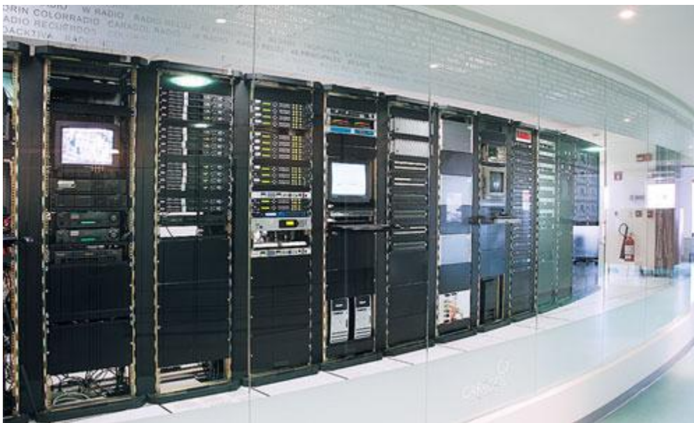
Figura 24: Rack de equipos de Caracol Radio
