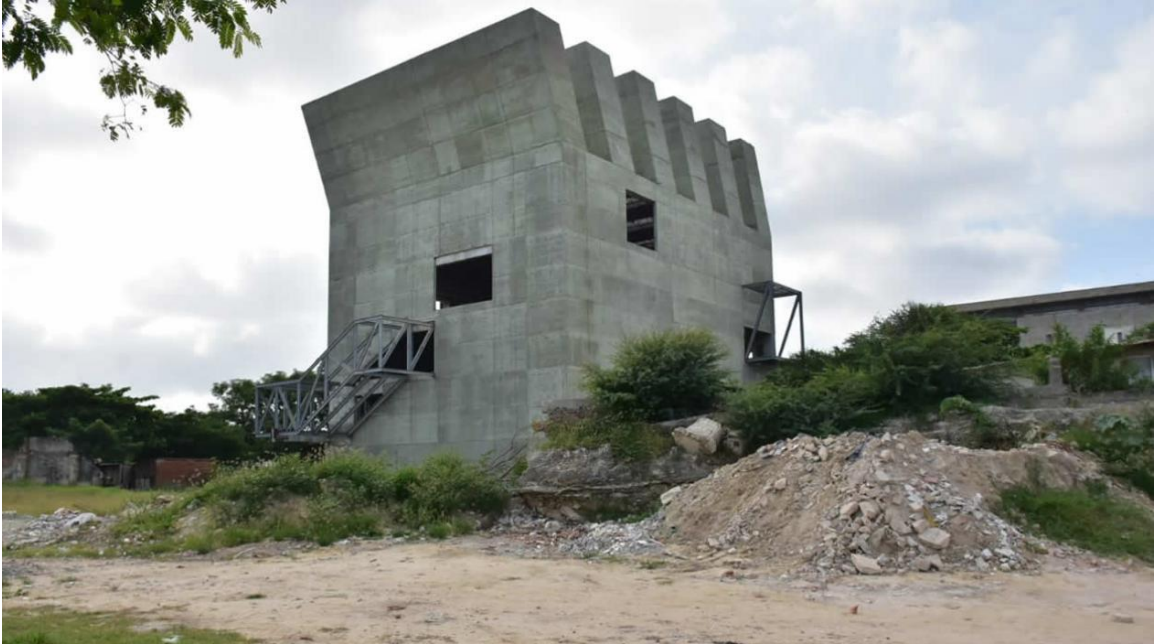
Imagen 6: Obra paralizada del Museo de Arte Moderno de Barranquilla. (Zona Cero, 2019)
