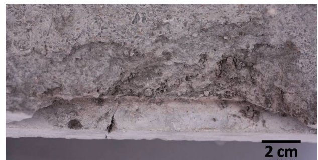
Fig. 5 Powdery clay material on the AV slabs
