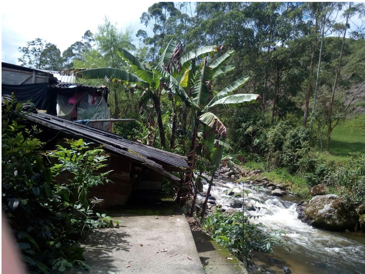
Fotografía 19. Vivienda ubicada sobre la obra de defensa contra las inundaciones del río San Eugenio.
