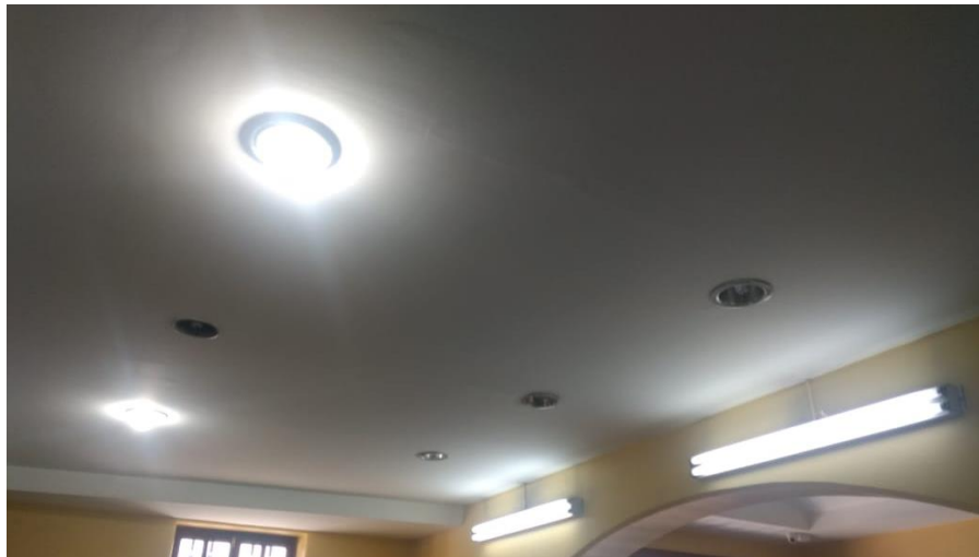
Figura 4. Iluminación del centro de salud. [Autor]
