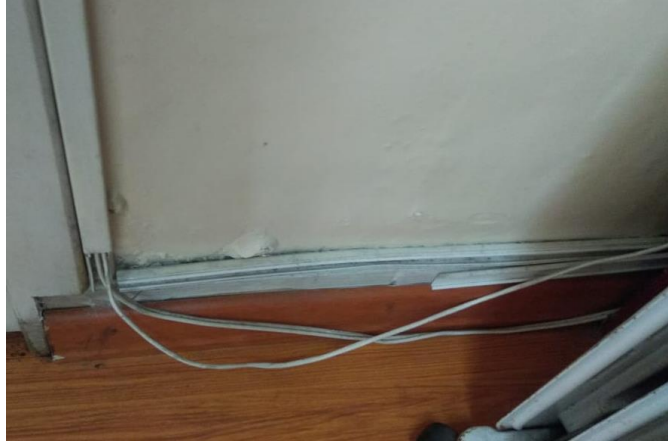
Figura 3. Circuitos expuestos. [Autor]
