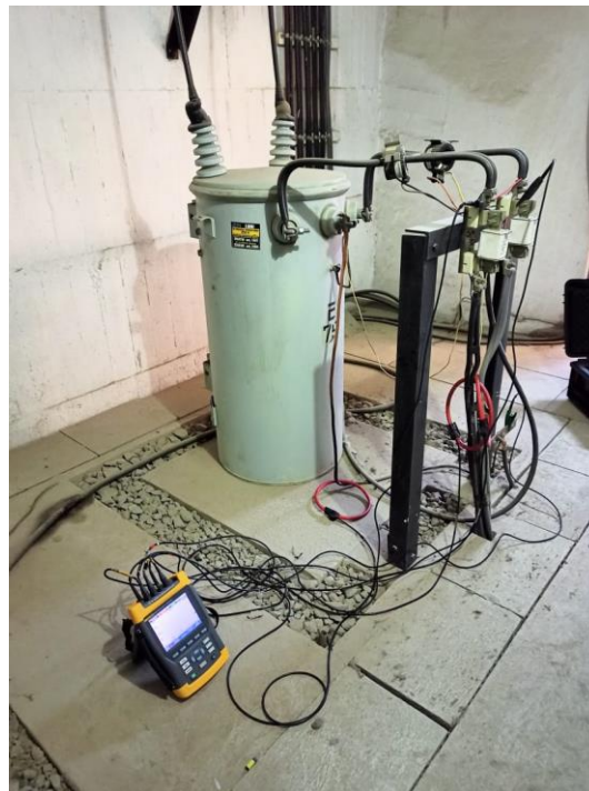
Figura 9. Transformador bifásico de 75kVA. [Autor]
