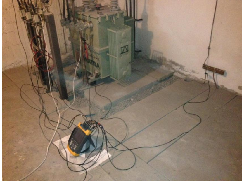
Figura 10. Transformador trifásico de 100kVA. [Autor]
