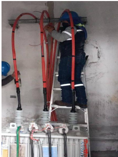
Figura 15. Conector tipo interior conexión al bushing del transformador (COTO-EEASA-053-2020). Autor: Consorcio DG.
