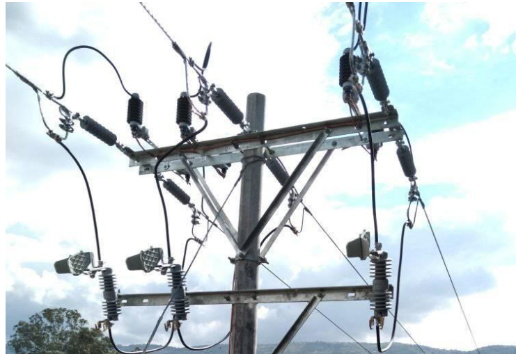
Figura 5. Seccionadores y pararrayos (COTO-EEASA-053-2020). Autor: Consorcio DG.
