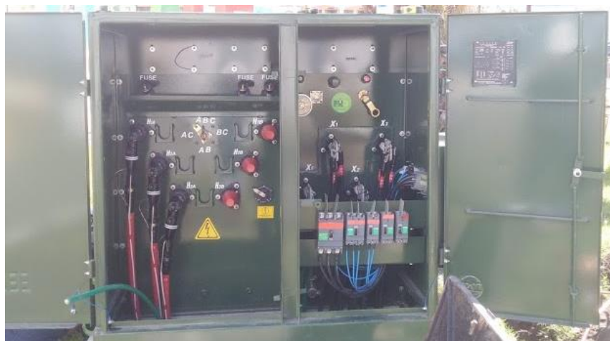
Figura 20. Transformador trifásico tipo anillado (COTO-EEASA-053-2020). Autor: Consorcio DG.
