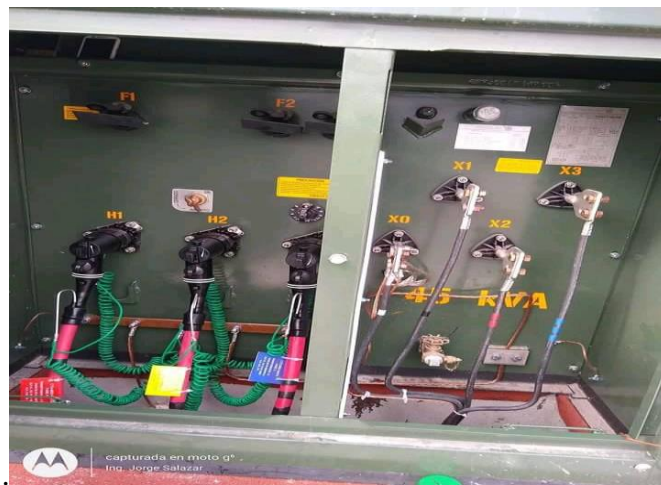
Figura 19. Transformador trifásico tipo radial (COTO-EEASA-053-2020). Autor: Consorcio DG.
