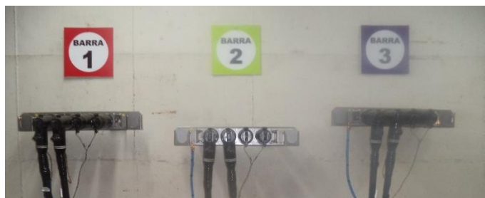
Figura 13. Barras de distribución subterráneas (COTO-EEASA-053-2020). Autor: Consorcio DG.
