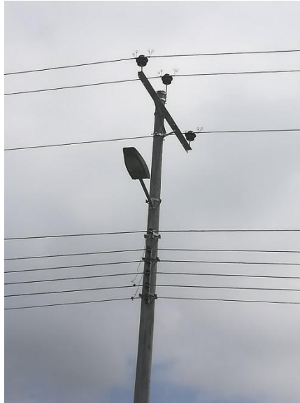
Figura 3. Estructura centrada pasante de media tensión (COTO-EEASA-053-2020). Autor: Consorcio DG.
