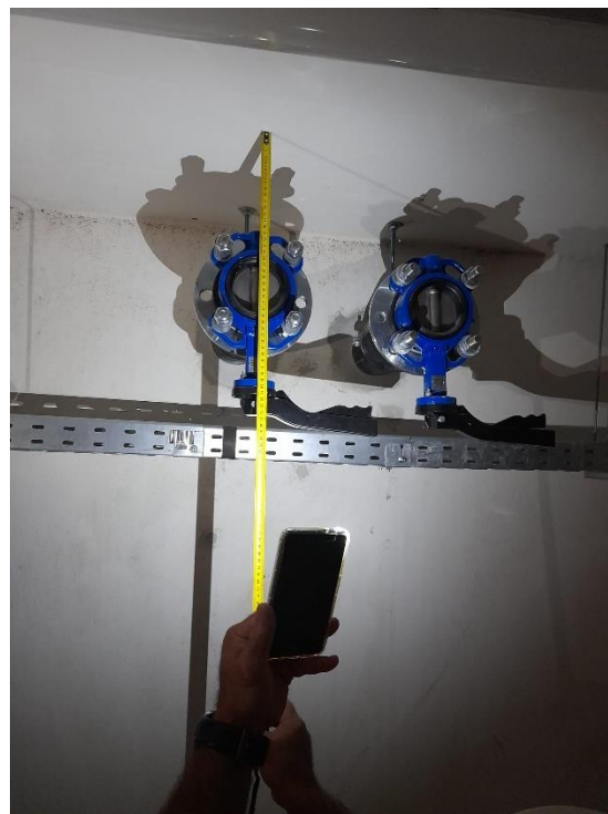
Figura 33 – Entrada tubagem geotermia nas caves das Villas
