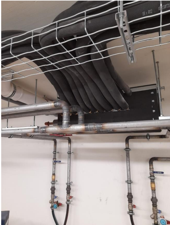
Figura 36 – BS, caixas de derivação da tubagem de cobre
