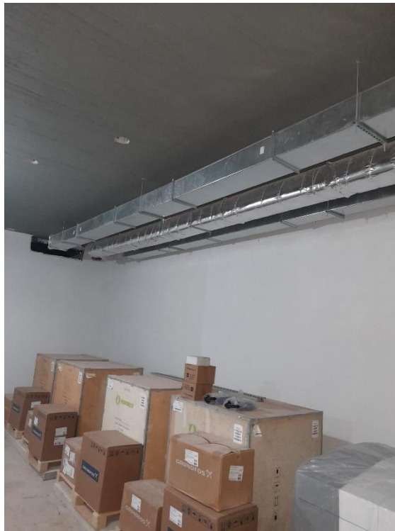
Figura 29 – Central Técnica Bombas
