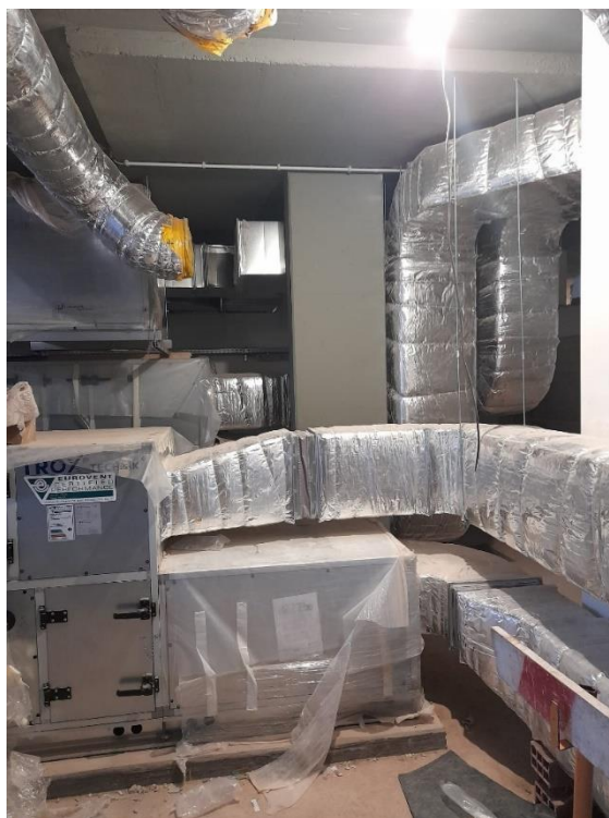
Figura 28 – Central Técnica UTAs
