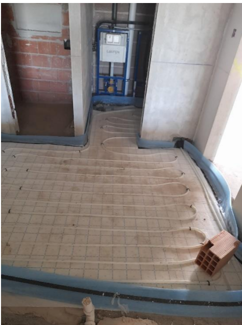
Figura 38 – Pavimento Radiante Villas
