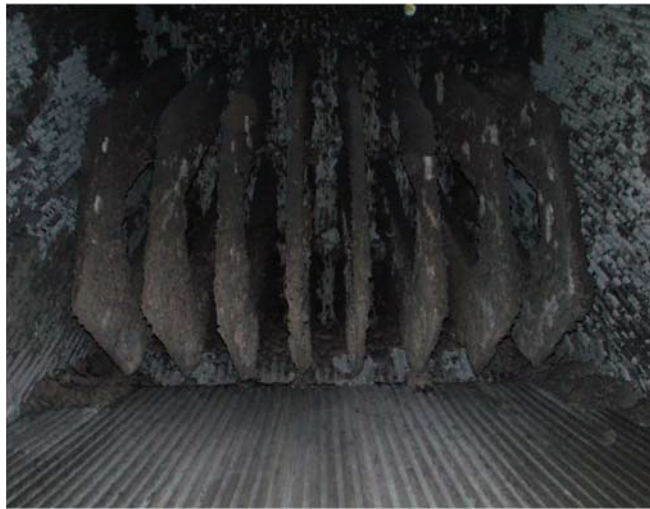
Figura 23. Depósitos formados en los superheater de una planta de combustión de biomasa [42].
