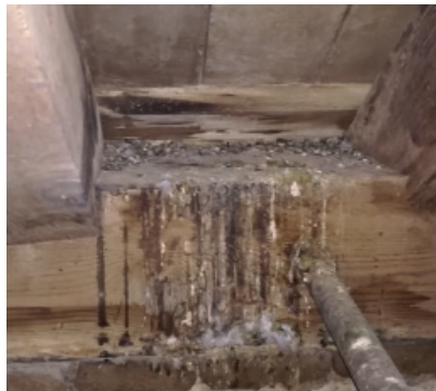
Fig. 1.51_Grandes depósitos de suciedad
