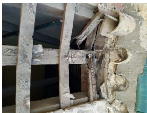
Fig. 1.41_Cumbrera de EP4 antes de la reparación
