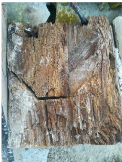
Fig. 1.80_Estribo atacado insectos xilófagos y pudrición parda
