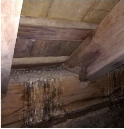
Fig. 1.93_Importante presencia de humedad en estribo y cabeza de par
