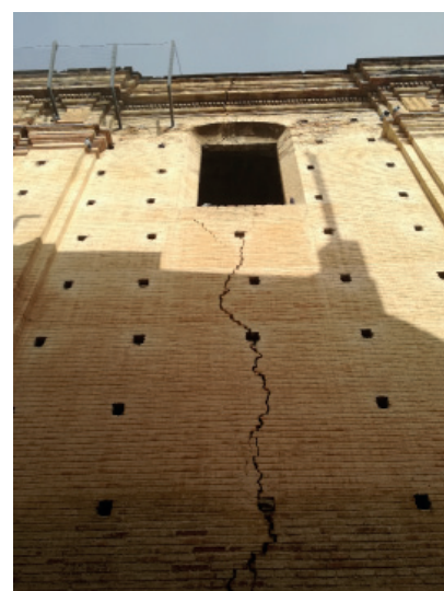
Fig. 1.16_Importante grieta en muro Sur
