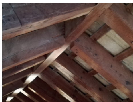
Fig. 1.65_Entrega incompleta de pares en la hilera
