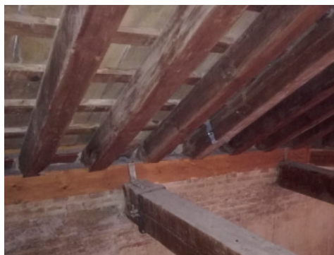
Fig. 1.30_Refuerzos metálicos en tirantes
