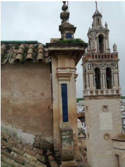
Fig. 1.55_Desplomado de la mansarda
