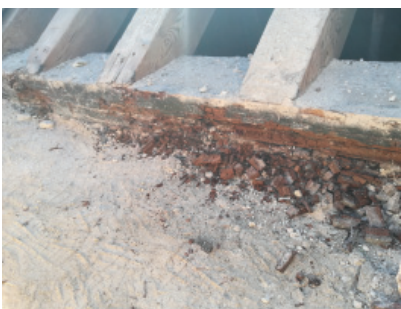
Fig. 1.125_Estado del enlace debido a la pudrición
