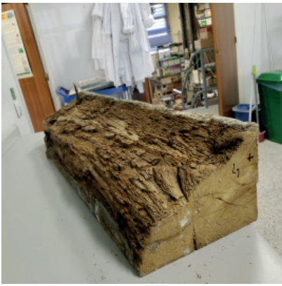
Fig. 1.98_Afección de la pudrición parta al estribo
