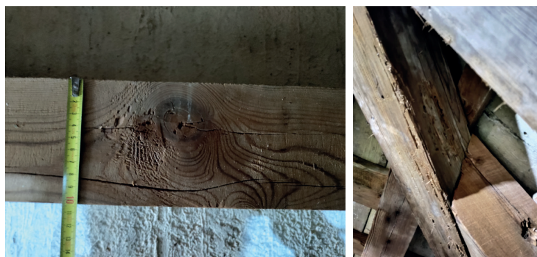
Fig. 1.111_Clasificación visual de los elementos de la armadura mediante la medición in-situ
