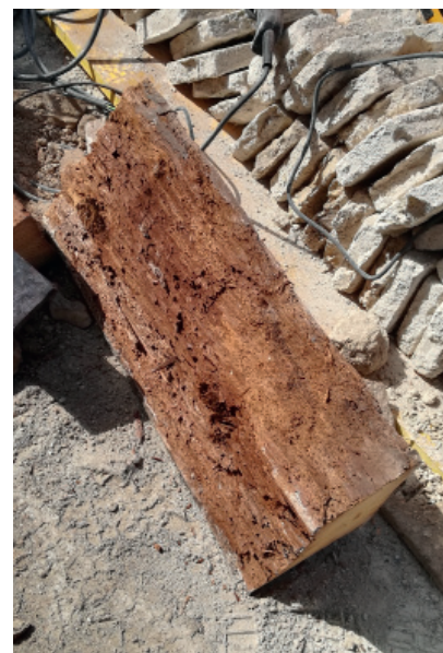
Fig. 1.108_Todos los estribos estaban afectados por la humedad y la pudrición
