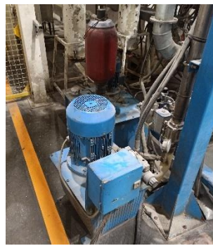
Figura 12 – Bomba hidráulica do câmbio de filtros
