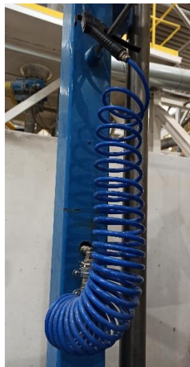
Figura 11 - Reposicionamento da mangueira de ar comprimido
