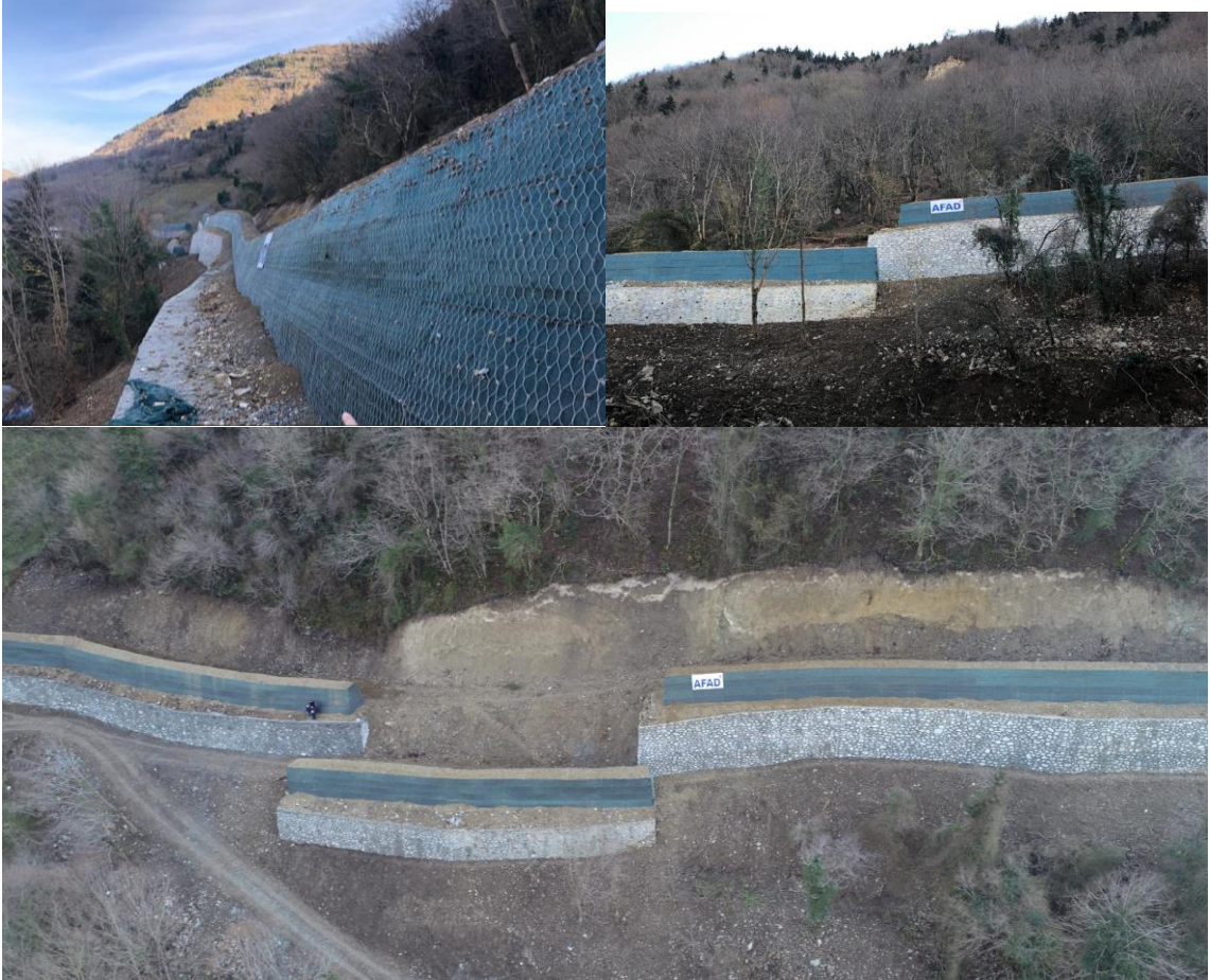
Şekil 14: Trabzon Maçka ilçesi güney mahallesinde taş duvar üzerine yapılmış toprakarme duvar imalatı
