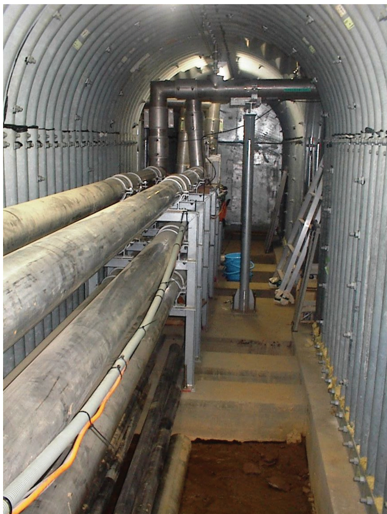
図 22 130kl 水槽横に建設した波状鉄板製配管格納庫 Fig. 22. Steel corrugated shed for piping, near the 130kl water tank.
