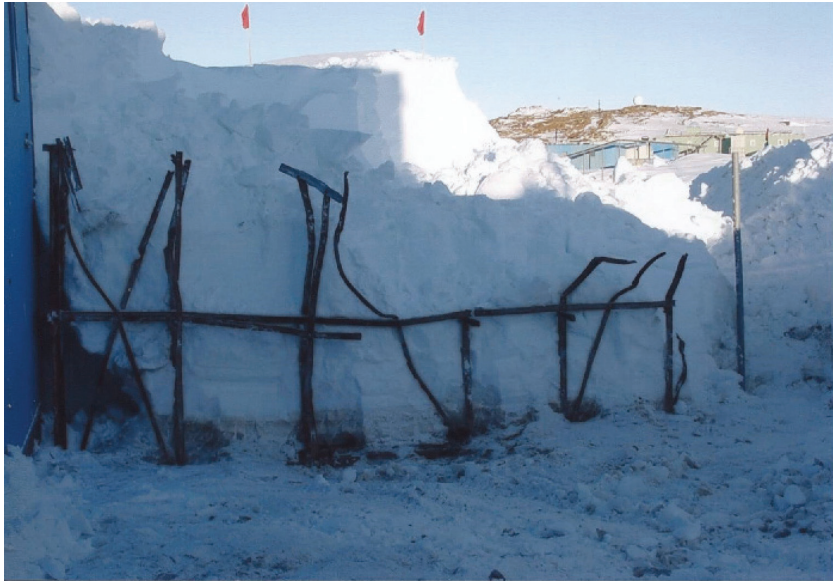
図 20 雪の沈降力で破損した配線架台 (2005年10月1日撮影) Fig. 20. Wiring support destroyed by settling snow (Oct. 1, 2005).
