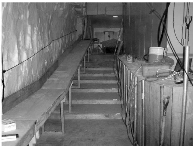
図 16 新旧掘削場間に位置する机 5 の状況 (西側)。左側に土留め (9 月 15 日)
