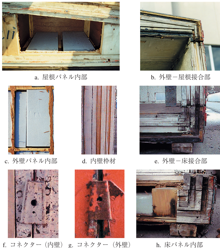
図 5 各部の劣化状況
