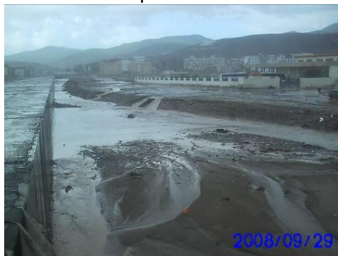
Figure 19: Photo d'oued kandissa Après les inondations du 29-09-2008.
