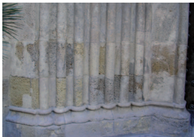
Incrustaciones en las jambas estriadas del arco ojival de la portada de la iglesia de Santa Ana Fotos: P. Ortiz, M. S. Abad
