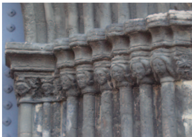
Depósito y costras negras en arquivolta, jamba e imposta de la portada principal de Omnium Sanctorum
