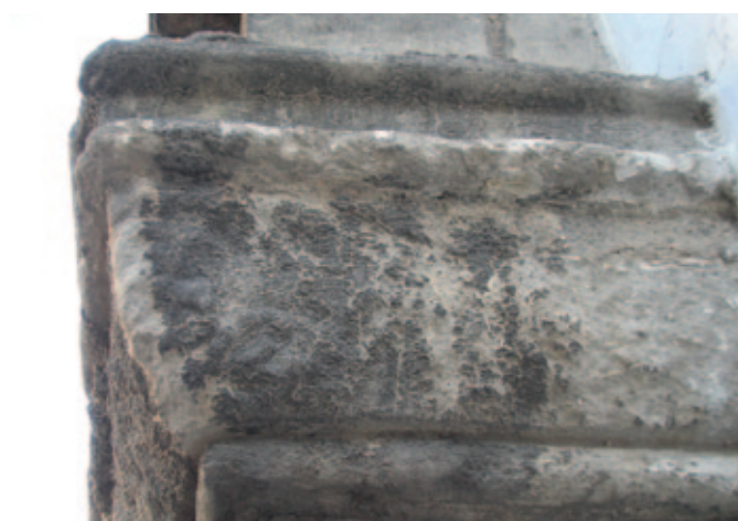
Depósitos en la imposta de la iglesia de Santa Catalina
