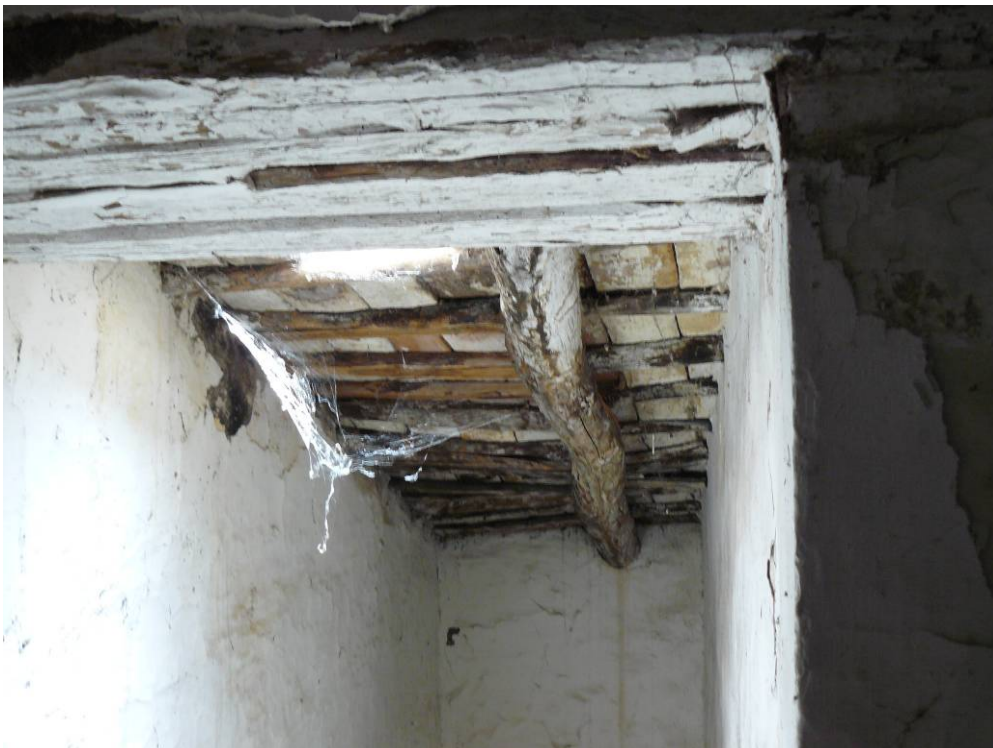
Fig.14 “Re-pensamiento de ruina/armario empotrado en Guadalcanal, Sevilla. Estado inicial de ruina. Arq.: estudio republica_dm”
