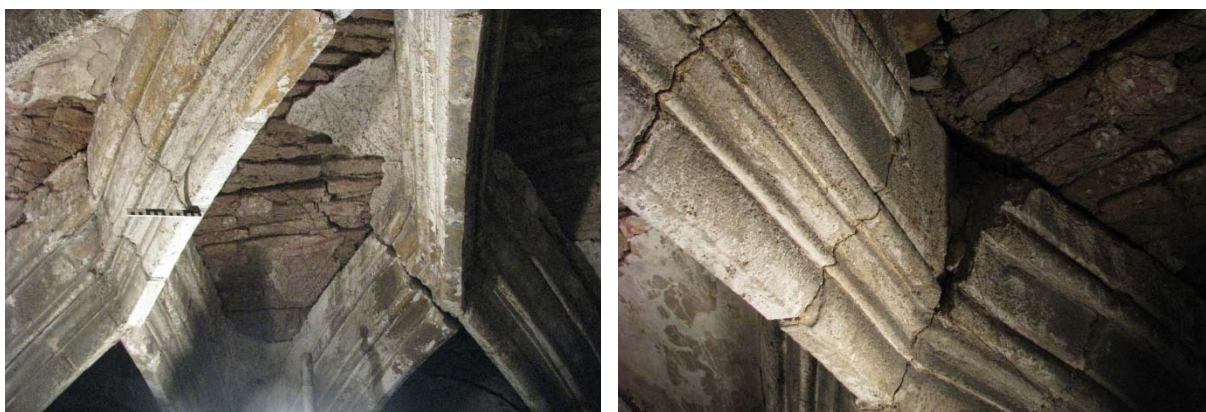
Figura 5. Grietas y desplazamientos en los nervios.
