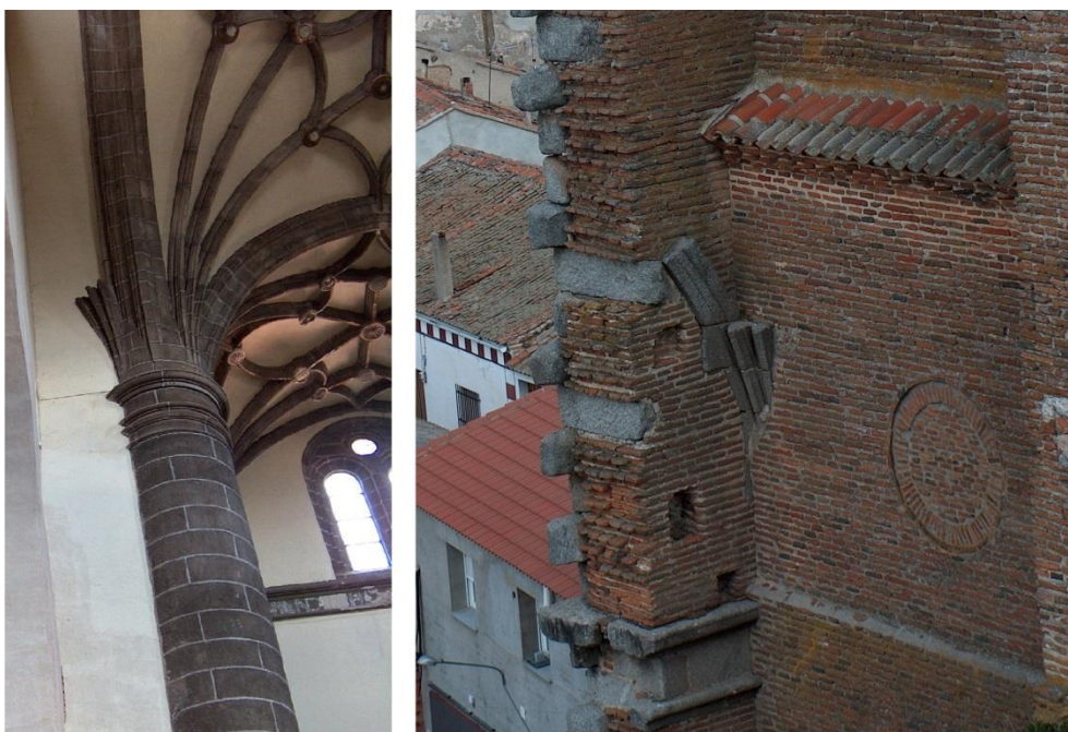
3. Arranque de nervios en la nave del evangelio y muro exterior con enjarjes, friso y nervios, en espera para continuar dicha nave tanto en exterior como interior.
