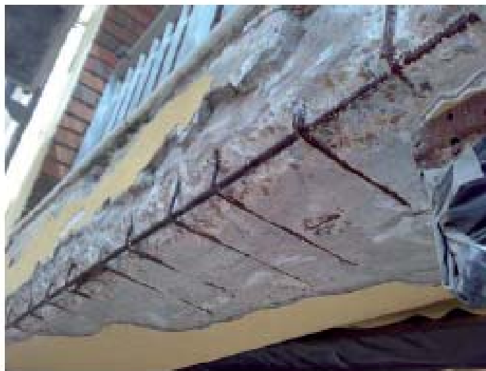
Figura 2-13. Corrosión de armaduras de acero al carbono en un edificio próximo a la costa
