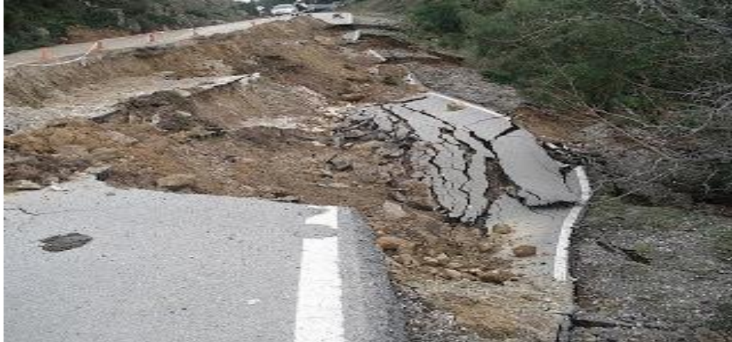
Ilustración 66. Otros problemas de deslizamiento que afectan a viario en Jimena (2007). http://www.laopiniondemalaga.es/municipios/2013/05/22/lluvia-provoca-hundimiento-carretera-gaucin/589785.html
