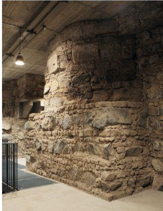
Ilustración 11. Cimentación a base de mampuestos y verdugadas de ladrillo bajo grandes machones. www.koelner-dom.de Der Kölner Dom.
