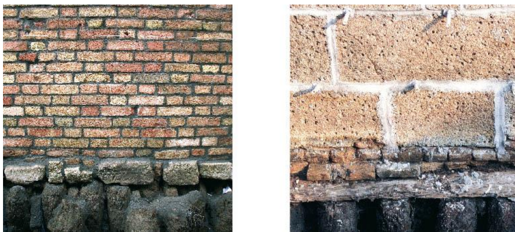
Ilustración 8. Cimentaciones venecianas con pilotes de madera. www.venicebackstage.org (2009) "Cimientos en los Palacios Venecianos".
