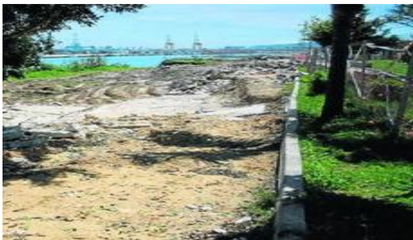
Ilustración 67. Deslizamientos en el Paseo de la Cornisa (Algeciras, 2010). http://www.europasur.es/article/algeciras/682529/arreglo/paseo/la/cornisa/pendiente/unos/estudios/geotecnicos.html
