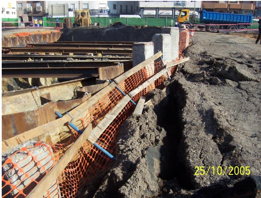
Ilustración 96. Derrumbe del sistema de entibación.
