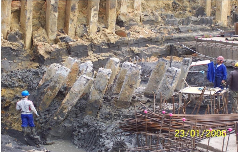
Ilustración 98. Inclinación producida en los pilotes de hinca.
