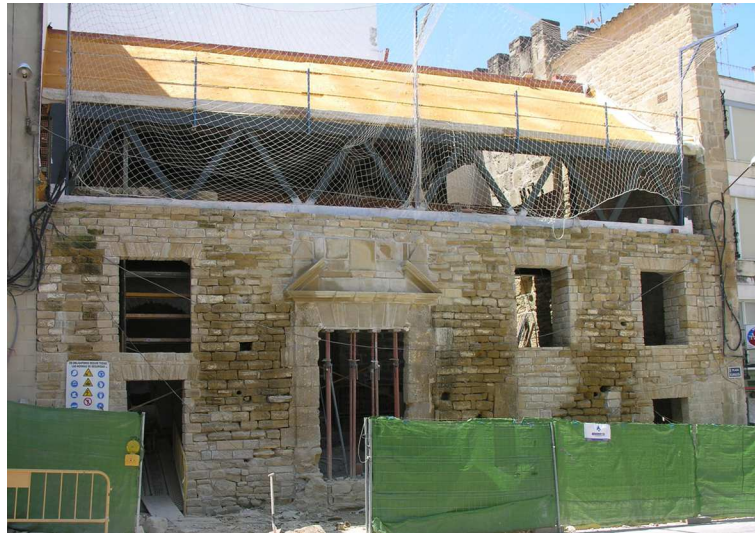
Fig 7. Muro de fachada en el proceso de restauración y restitución de piezas. 2011. ARQVIPO.
