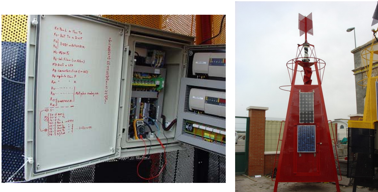
Figura 2. Boya y armarios de dispositivos.
