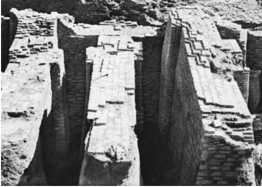
Figura 5 Tres muros apilastrados del Hipogeo de los Patesis Ur-Ningursu y Ugme en Tello (s. XXII a.C.) (Parrot 1969, 203 fig. 250)
