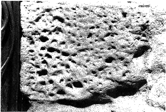
c) Alveolización en zócalos húmedos y aireados.
