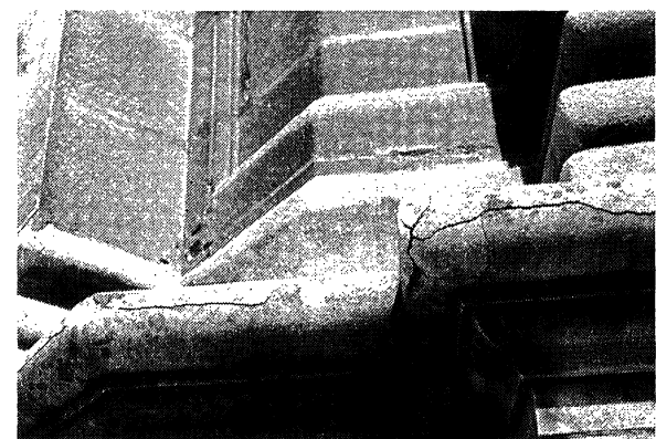
f) Fisuras en el cemento de las portadas. f) Fissuring on cement of the front.
