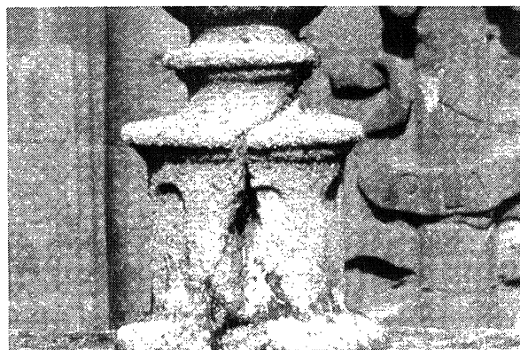
e) Fisuración por oxidación de las espigas metálicas de sujeción. e) Fissuring due to oxidation of the metal spike-holders.
