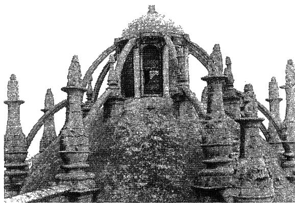
b) Diversas rupturas por oxidación de las espigas metálicas de sujeción.
