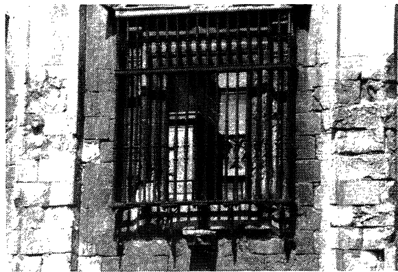
d) Rupturas, disgregaciones y pulverizaciones en ciertas pilastras.
