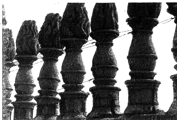
c) Ruptura total de la base de los flameros con espigas metálicas.
