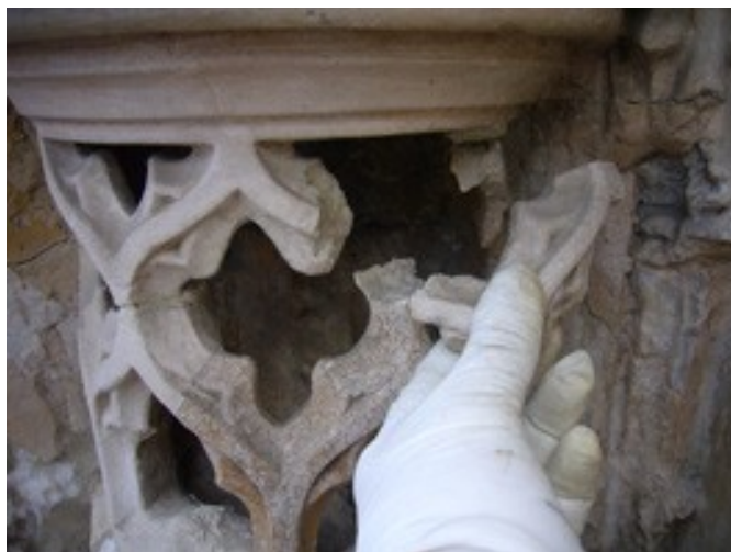
Foto 4.- Detección de una fractura en una pieza de alabastro. Puerta del Perdón.
