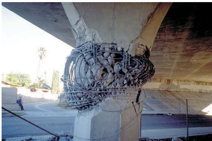
Figure 2.3 – Rupture d'un pilier par flambement des armatures longitudinales à sa base.
