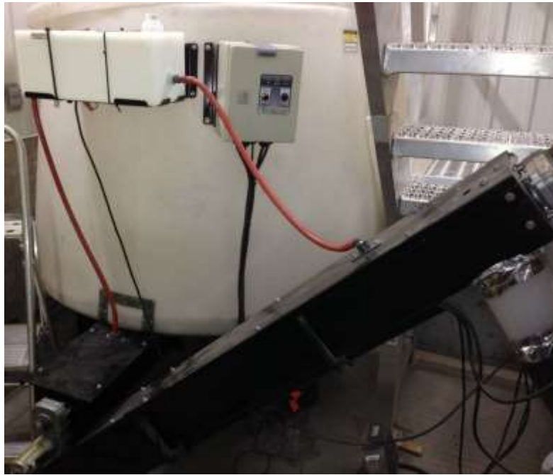
Figure 3.3 Trémie d'alimentation du Bio-Burner
