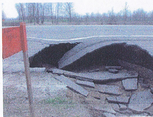
Photo 1. 1 Effondrement de l'autoroute 40 le 05/05/2002
