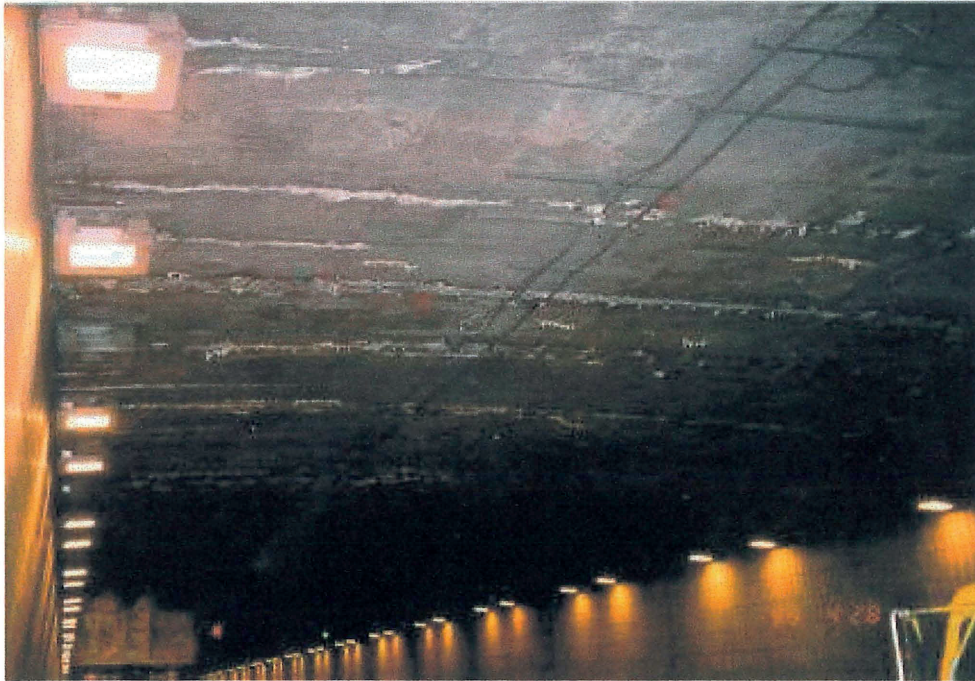
Photo 2.1 Fissuration et venue d'eau diffuses au niveau de la voûte d'un tunnel (L.-H.-Lafontaine)
