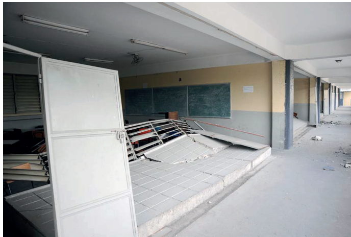
Figure 1.3 Rupture en porte-à-faux de murs de cloison en maçonnerie non armée lors du tremblement de terre d'Haïti en 2010 (Photo : Patrick Paultre)
