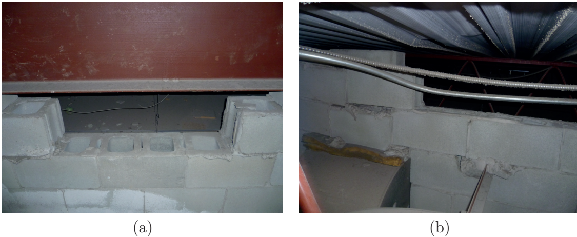
Figure 2.15 Murs non supportés latéralement dans une école de la commission de la région de Sherbrooke (a) mur de cloison prolongé jusqu'en dessous d'une poutre (b) mur de cloison prolongé jusqu'en dessous du tablier métallique
