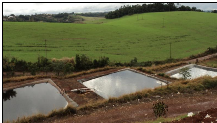
Figura 06 – lagoas de tratamento de percolado
