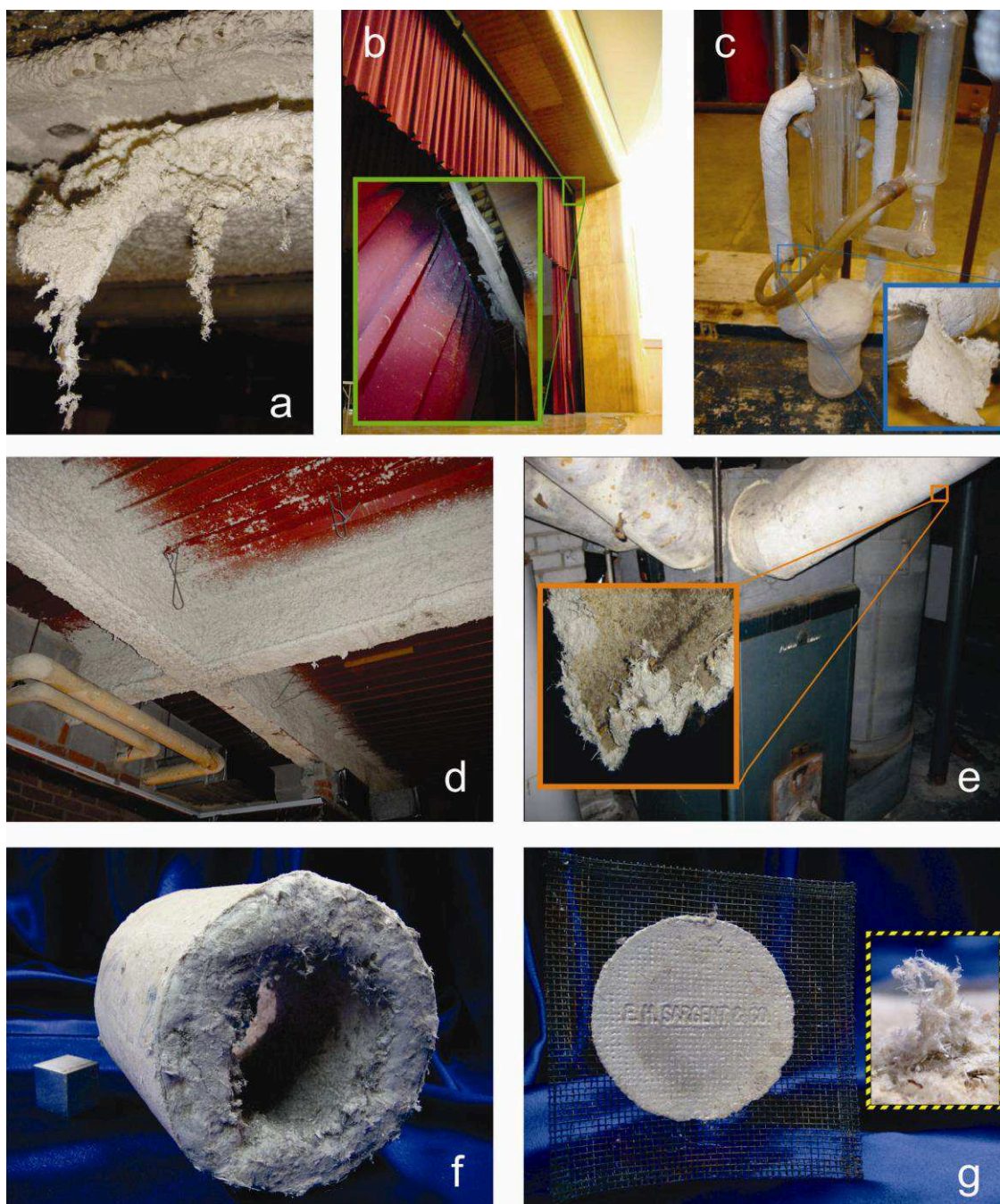
9.5. ábra: Különböző típusú azbesztszigetelések. a) Szórt krizotil hangszigetelés plafonon, az azbesztburkolat lazul, a peremen elválnak a habarcsztól. b) Szinpadi fehér tűzszigetelő azbeszttextil függöny, feltekert állapotban. Az anyag sérült, a kiszabaduló szálkötegek szennyezik a piros színházfüggönyt is. c) Azbesztpapír-szigetelés extrém hőmérsékleteknek (meleg és hideg) kitett laboratóriumi kísérleti üvegeszközön, krizotilból. d) 1968-as szórt azbeszt tűzvédelmi szigetelés szerkezeti vasgerendán, krizotilazbeszt tartalma kb. 25%. e) Azbesztpapír hőszigetelés kazán szellőzővezeték körül. f) Gőzvezetékek hőszigetelésére tervezett, kb. 85% magnéziát (MgO, magas olvadáspontú, fehér, porlódó, tűzálló anyag) és 15% azbesztet (krizotil és amozit) tartalmazó csőburkolat. A mállékony burkolat két félből áll össze, és az egészet vékony vászonburkolat veszi körül (a léptékként használt kocka éle 2,54 cm). g) Málló felszínű, laboratóriumi azbesztháló: melegítésnél a melegítendő üvegedényt erre teszik, hogy ne érje a Bunsen-égő közvetlen hője. Mai azbesztmentes utódai sokszor kerámiaszállal készülnek. A képek forrása: © Asbestorama – flickr.com
