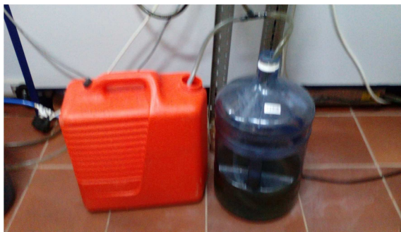
Figura 4.2 Depósitos de agua bruta
