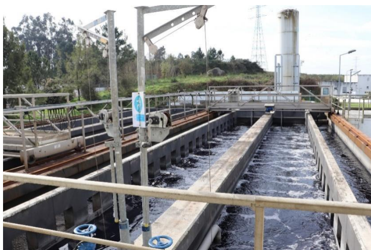
Figura 17: Desarenador e desengordurador da ETAR de Serzedelo II.
