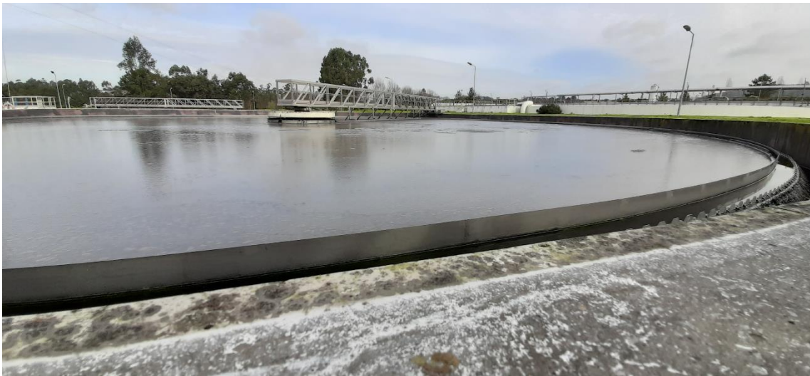
Figura 20 e Figura 21: Decantador secundário da ETAR de Serzedelo II.
