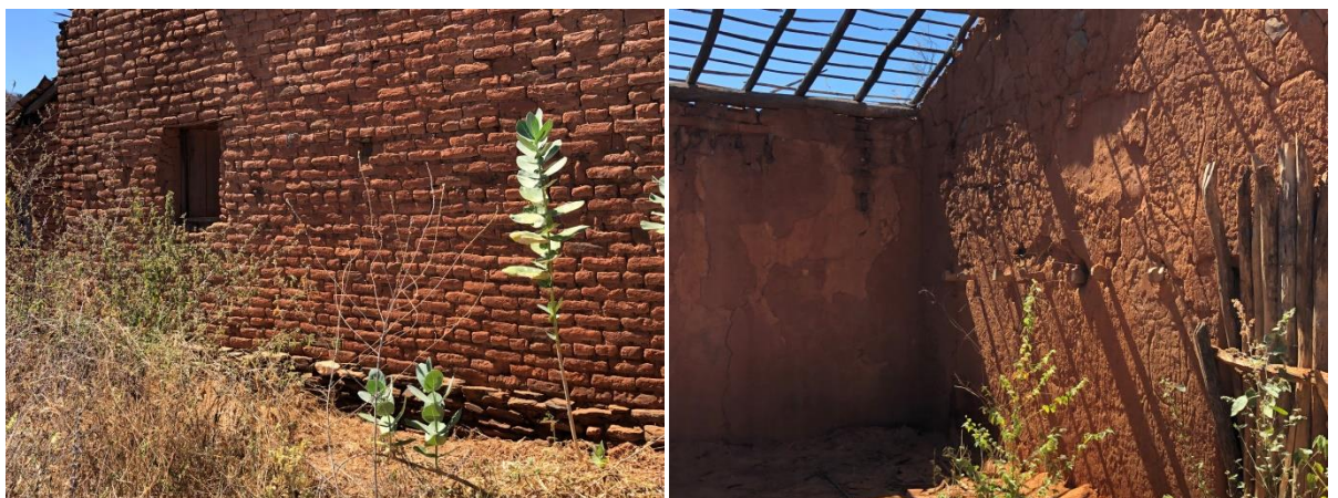
Figuras 12 e 13 - Vista da casa já em ruínas
