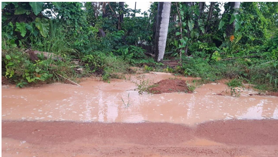
Figura 11 - Assoreamento direcionamento águas pluviais
