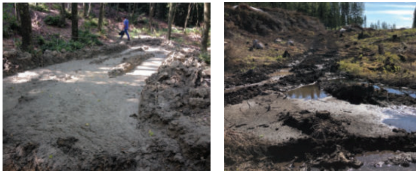
Figura 24: Colate di fango (sinistra) e ristagno idrico (destra) formatesi in seguito a forte pioggia in un cantiere forestale
