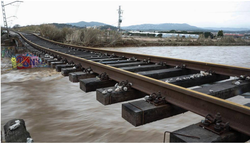
Figura 9: Trencament del pont ferroviari de la línia R1 degut el temporal Glòria. Font: ( Un Hombre Muerto En Ametlla de Mar Eleva a 13 Las Víctimas Mortales Por La Borrasca 'Gloria,' n.d.)
