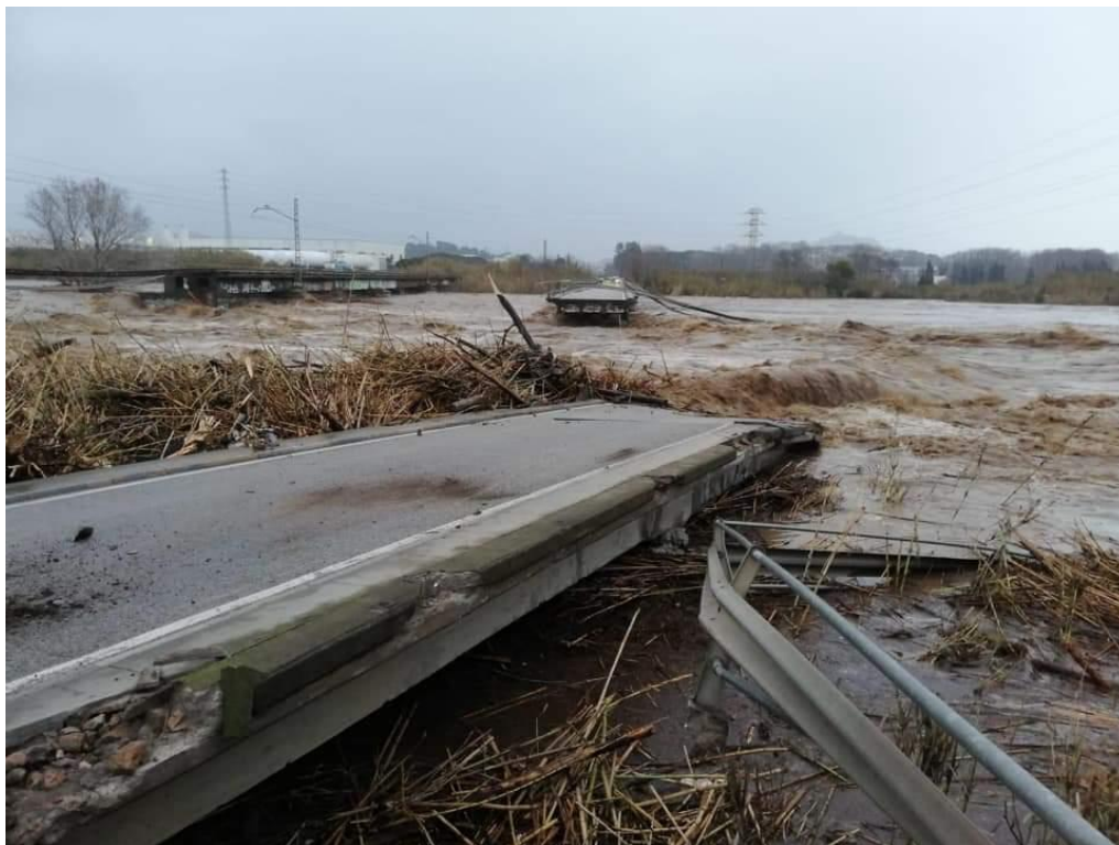
Figura 10: Trencament del pont de la carretera. Font: ( Reformar Lo Que Ya Existe Para Resistir Lo Que Vendrá , n.d.)
