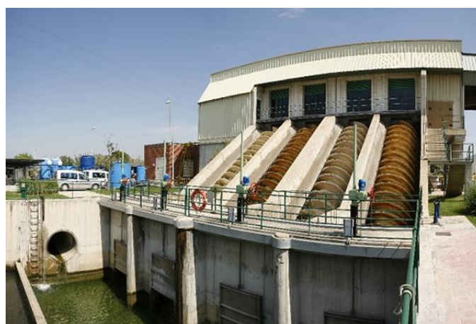
Figura 7.16. Cargols Arquímedes i cambra d'aspiració del bombament intermedi a la ETAP de Sant Joan Despí
