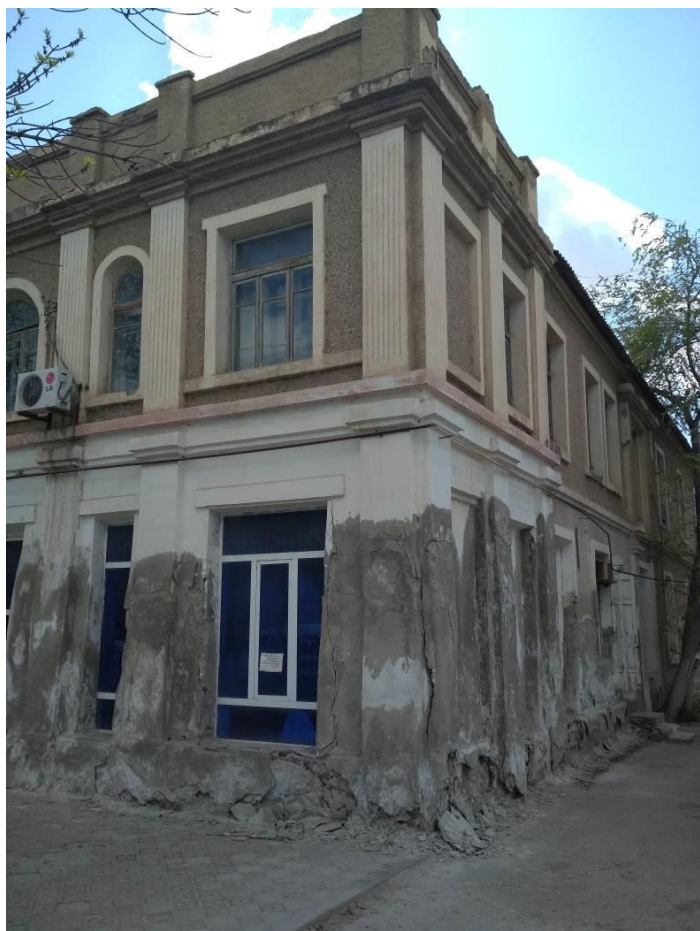
Рисунок 2. – Характер разрушения здания по ул. А. Шамуратовой г. Нукуса (2018 г)
