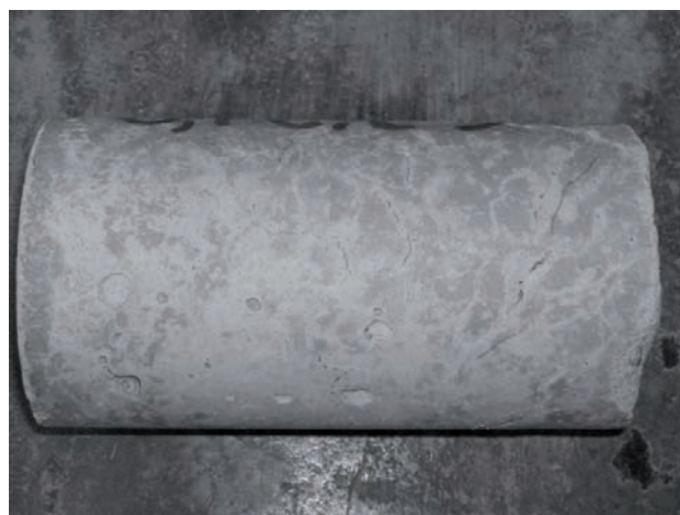
Figura 11. Fisuras a lo largo del perímetro lateral.
