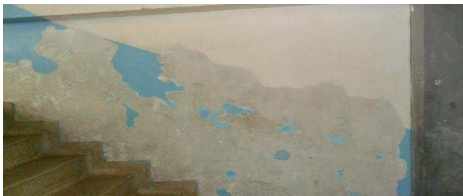
Figura 10. Deterioro en la pintura de muro de concreto.
