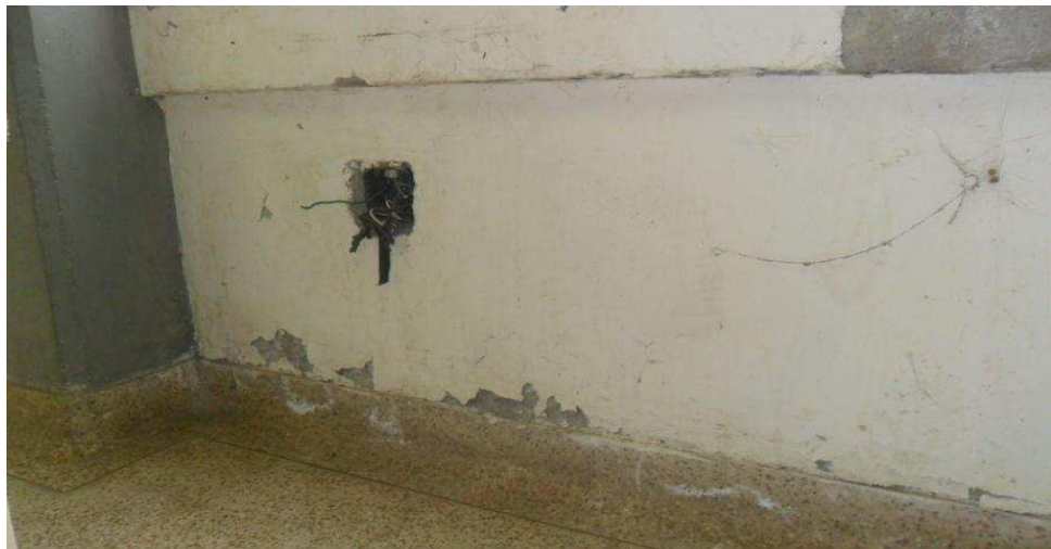
Figura 23. Toma eléctrico sin tapa.
