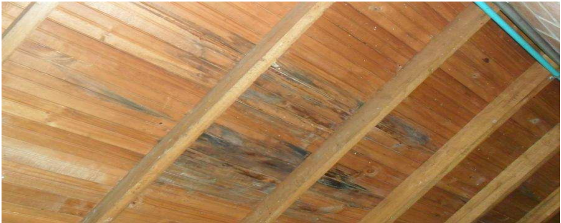
Figura 13. Deterioro del cielorraso por presencia de humedad.
