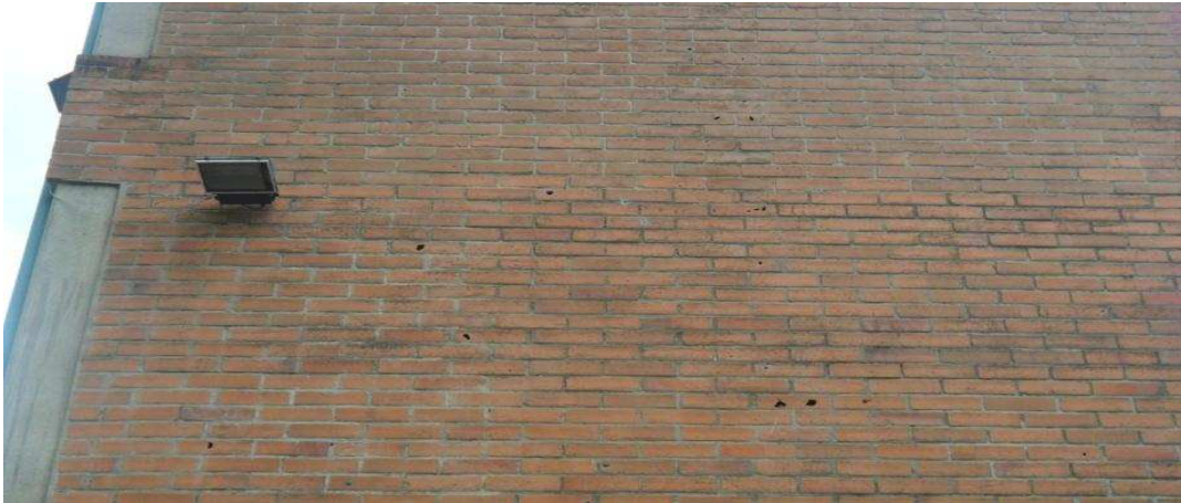
Figura 9. Muro en mampostería manchado por agresiones ambientales.
