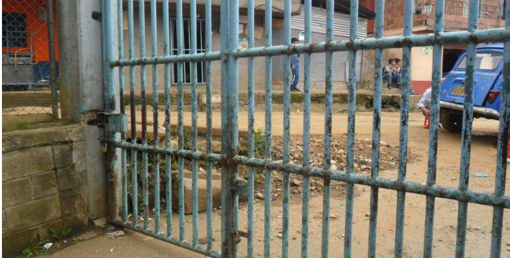
Figura 22. Corrosión y pérdida de revestimiento en reja principal.
