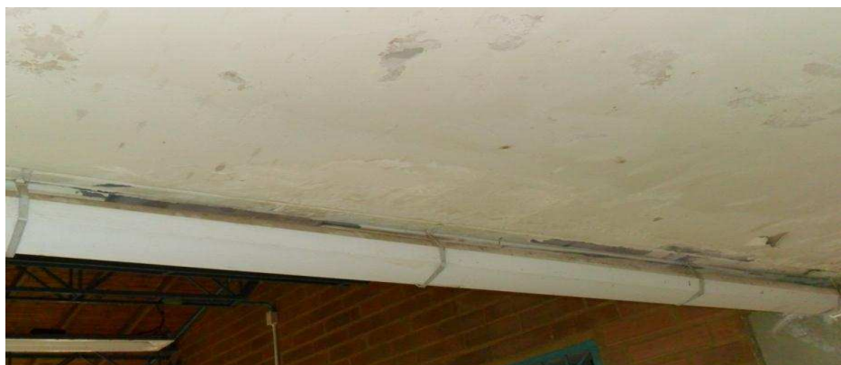
Figura 14. Descascaramiento de revestimiento del cielorraso en concreto.
