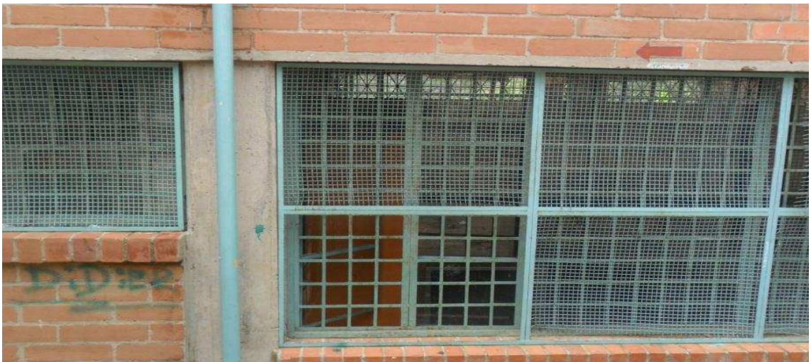
Figura 27. Ventana sin vidrio de protección.
