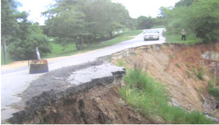
<그림 4-20> 지표수 과다흡수에 의한 도로 붕괴
