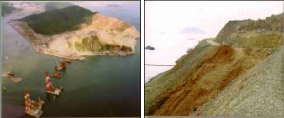
<그림 4-9> 부산신항만 건설로 인한 산림 및 자연훼손 전경
