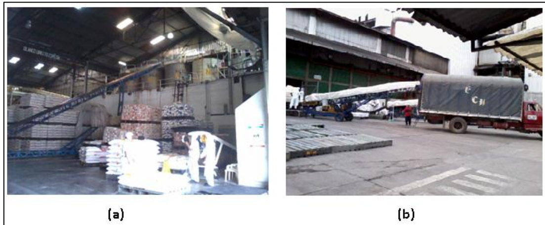
Ilustración 9. (a) Banda transportadoras, recepción producto blanco, natural y banda para alimentar silos para el producto familiar; (b) banda para cargue de camión.
