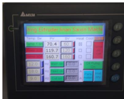
Figura 7. Sistema de control PLC, para control de temperaturas.
