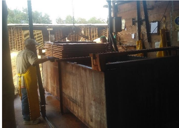
Figura 9. Tanque de inmunizado
