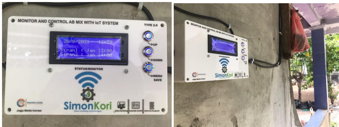
Gambar 4. Timer control berbasis mikrokontroler yang sudah terpasang
