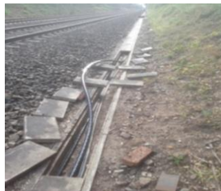
Abb. 2 Das schachtverlegte Glasfaserkabel entlang einer Bahnstrecke dient als Sensorkabel
